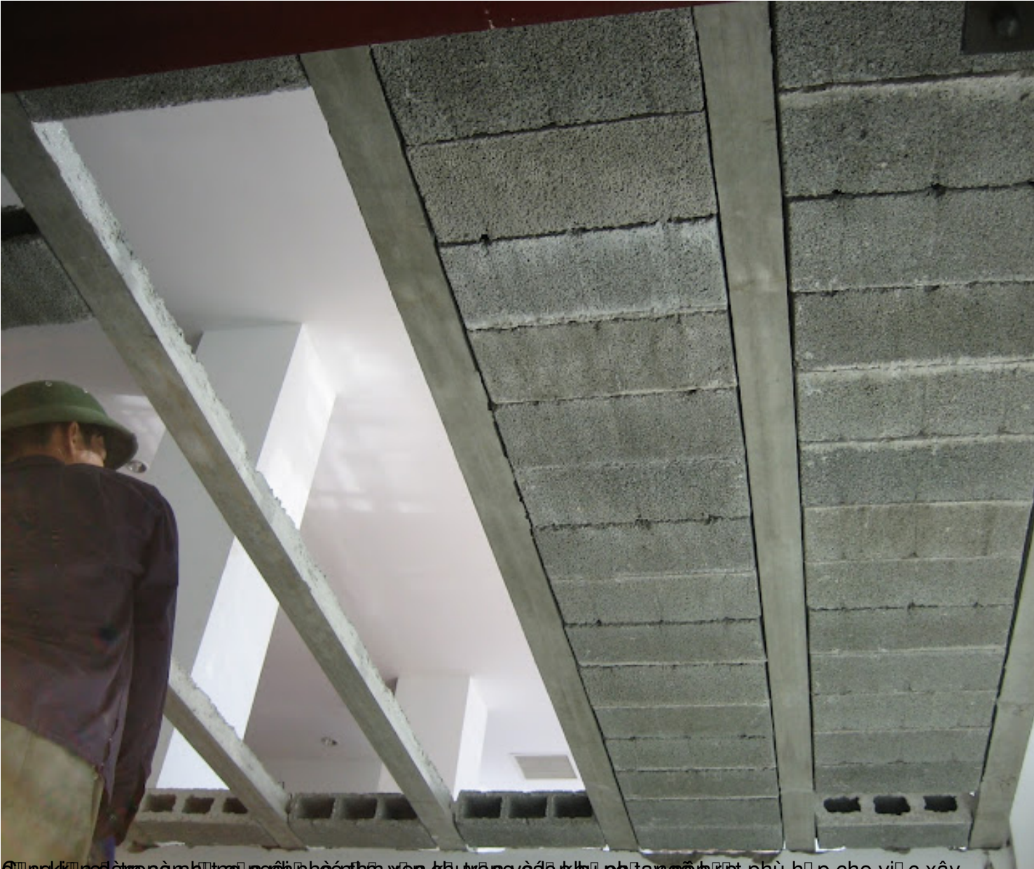
Công trình đã áp dụng hệ thống nền gạch nền và hệ thống các loại phụ kiện phù hợp cho việc xây
